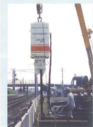
矢板規格：SP-II型 (L=6m) 発注：JR九州 工事名：羽犬塚駅構内自由路新設他
