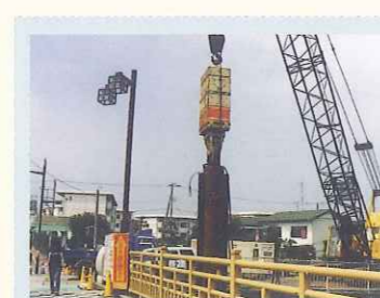
杭規格：φ600×12m 発注：神奈川県 工事名：総合治水対策特定河川工事(引地川)
