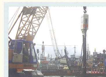
矢板規格：SP-III型 (L=16m) 発注：JR東日本 工事名：柳原構内新設工事
